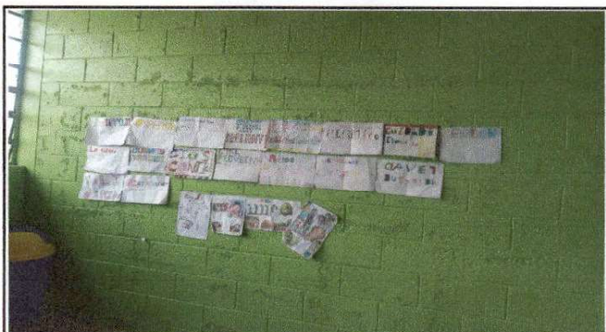
Foto 4: Repello de muro en mal estado.
