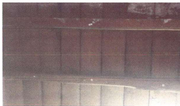
Foto 8: sustrucción de cielo falso en mal estado
