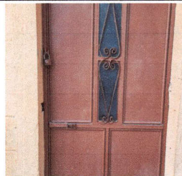
Foto 2: Puertas sin chapas.
