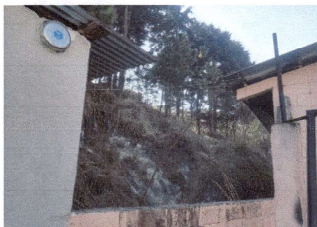
Foto 5: Falta la construcción de otra mitad de la pared, es parte de la circulación.
