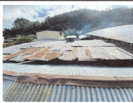
Foto 6: Cambio de techo de lamina de escenario para realizar diversas actividades dentro del centro educativo, mismo que y esta deteriorado por el tiempo de vida y uso del techo.
