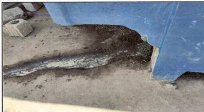
Foto 2: Drenaje actual de cocina al descubierto.
