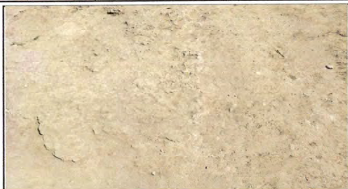
Foto 1: Estado actual del patio del INEB de Telesecundaria del Paraje Los Pinales, deteriorado.
