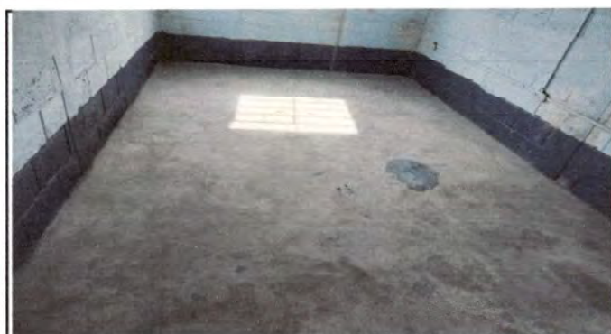
Foto 3: Piso a sustituir en la cocina.
