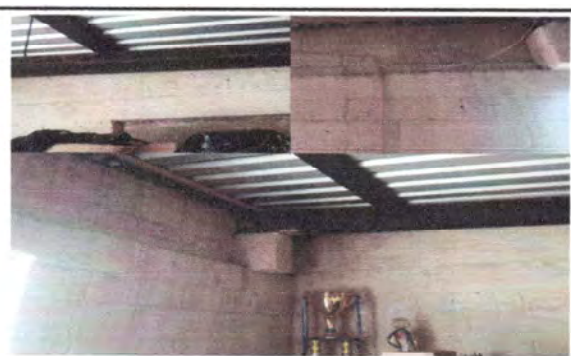
Foto 6: vista de paredes de dirección que serán repelladas, las que están dañadas por ingreso de agua de lluvia.
