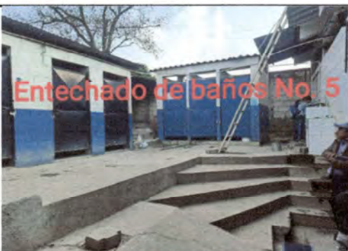
Foto 5: Mantenimiento Preventivo: El área de baños no cuenta con protección climática, generando humedad y riesgo sanitario. El entechado prevendrá daños en paredes y pisos, mejorando la habitabilidad
