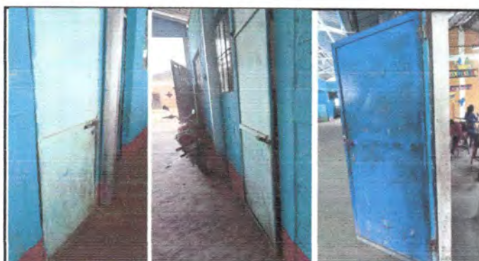
Foto 4: Cambio de puerta de primero, la dirección, puerta de segundo grado sección B y la puerta de cuarto grado por lo deteriorados que se encuentran y porque tiene sus más de 20 años de uso.
