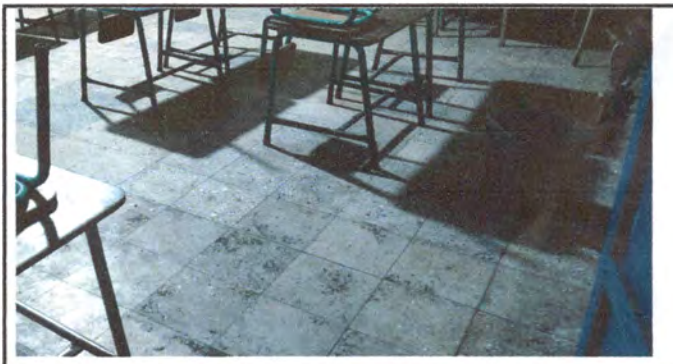
Foto 6: Piso en mal estado por el tiempo de uso
