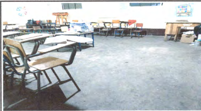
Foto 2: Piso en mal estado por el tiempo de uso
