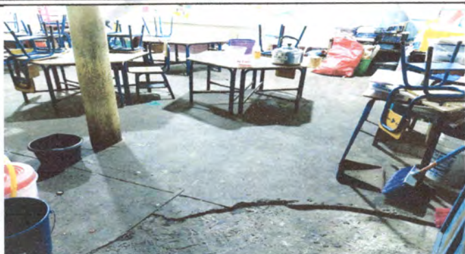
Foto 1: piso en mal estado por el tiempo de uso
