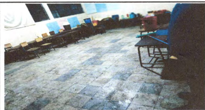
Foto 5: Piso en mal estado por el tiempo de uso
