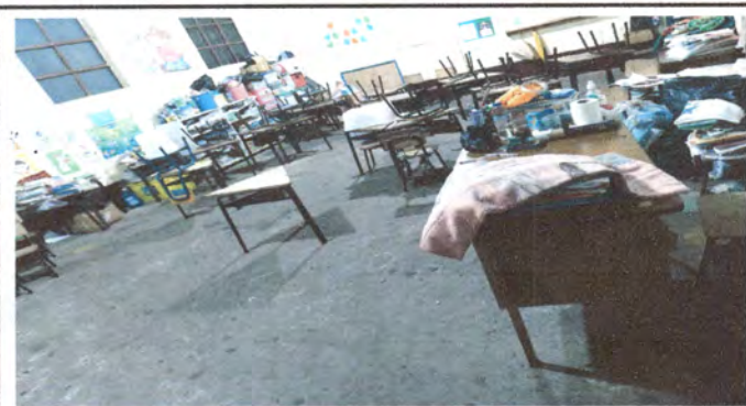
Foto 3: Piso en mal estado por el tiempo de uso
