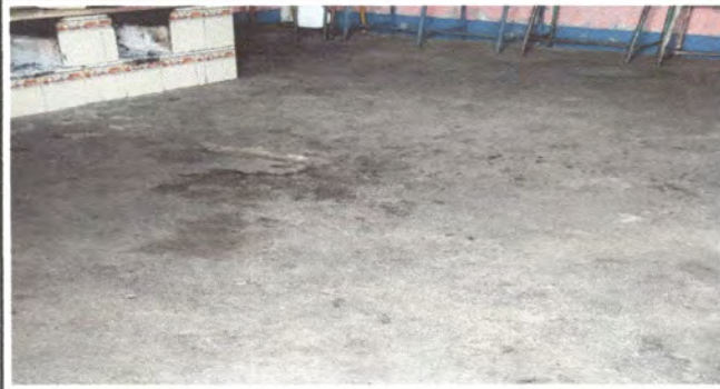
Foto 4: Fotografía de piso de la cocina
