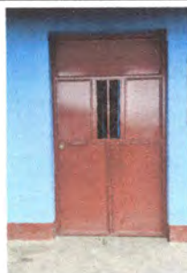
Foto 11: Puerta a darle mantenimiento de cocina
