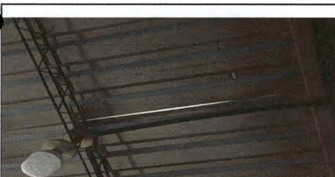
Foto 5: Colocar silicon en laminas que tienen filtración en tiempo de lluvia.
