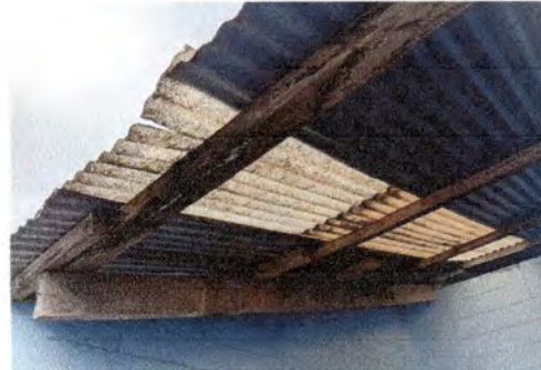
Foto 2: Reglas de madera para mantenimiento de techo de aulas, módulo B del edificio escolar.
