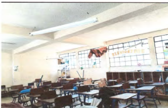
Foto 4: En el aula de quinto y sexto están en malas condiciones las 4 lámparas.
