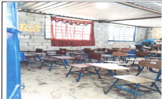
Foto1: El aula de primero primaria no está repellado, el piso es de torta de cemento, las dos ventanas están frágiles e incompleto la parte de arriba, hay una abertura donde ingresa polvo.
