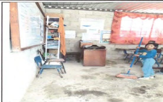
Foto 2: El aula de segundo y tercero primaria no está repellado, el piso es de torta de cemento, las dos ventanas están frágiles e incompleto la parte de arriba, hay una abertura donde ingresa polvo.
