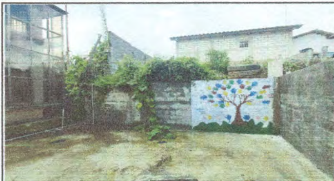
Foto 1: Muro Perimetral: Se necesita 18 metros de coronilla y una hilada de block , para contener las aguas pluviales y que no se inunde el Instituto
