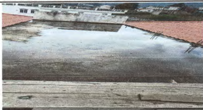
Foto 7: Colocar pañuelos para que las aguas pluviales no se estanquen en la terraza e ingrese a la cocina.
