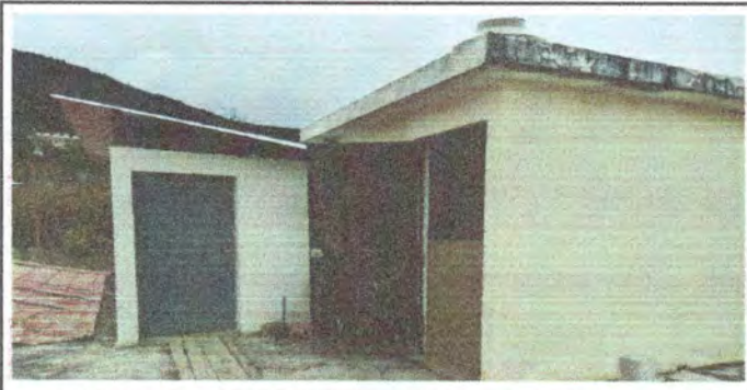
Foto 6: Sustituir Techo de la cocina y cambiar el desnivel para que no afecte la lluvia en las orillas de la terraza
