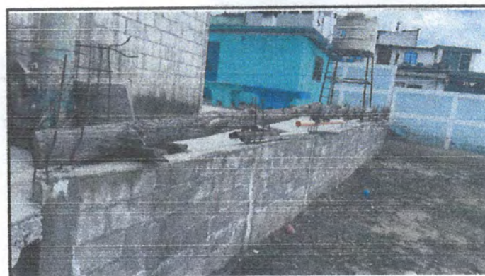
Foto 4: El muro interno representa peligro, se necesita colocación de barandas metálicas.
