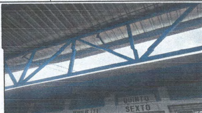
Foto 2: Los soportes de canales de agua pluvial están en mal estado y con espacio muy grande, cuando llueve no soportan el peso del agua y desborda.
