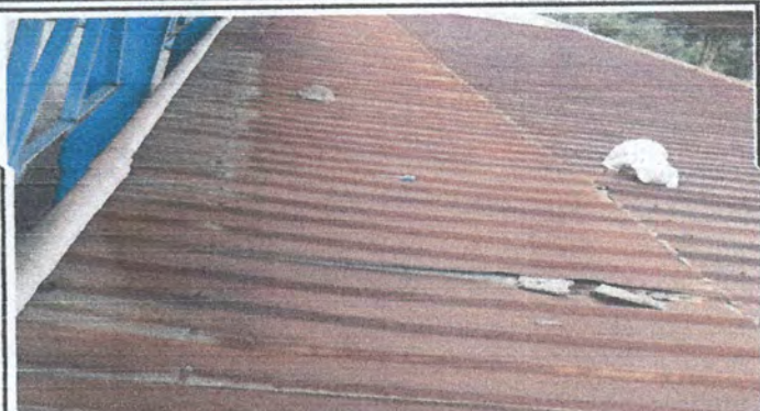
Foto 1: El techo presenta desgaste por el paso del tiempo y la corrosión,
