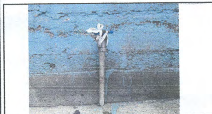
Foto 5: La red de agua entubada está deteriorada incluyendo los chorros en las tomas de agua para los niños y para la limpieza y uso de aulas y cocina.
