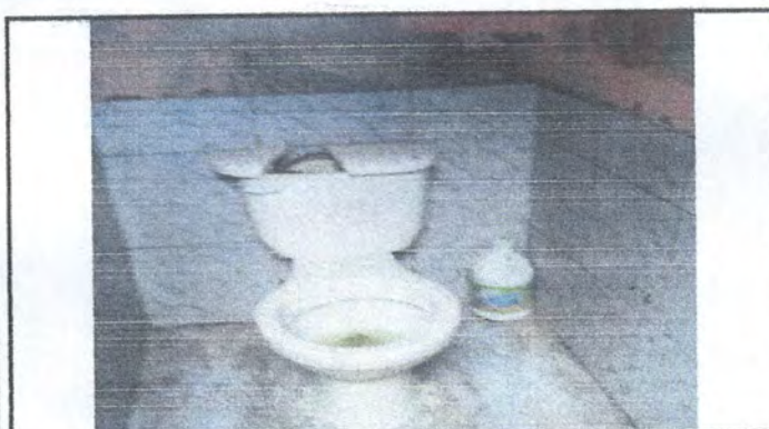
Foto 3: Los sanitarios y accesorios ya están deteriorados y no tienen suministro de agua para limpieza
