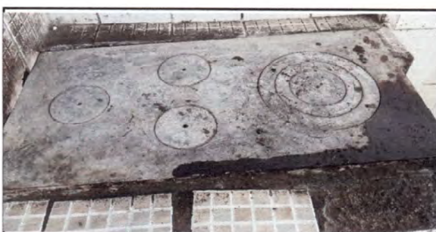
Foto 6: Vista de la plancha a sustituir.
