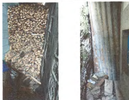
Foto 4: Ese espacio detrás de la leña es un área descubierta, se realizar una pared de 2.5 metros de alto por 1.5 de ancho, para sellar ese espacio. En la parte de atrás esta solamente cubierto por lamina hay que asegurarlo.
