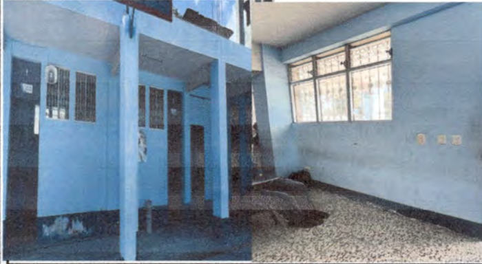
Foto1: Pintura en mal estado exterior e interior de las aulas
