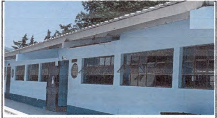
Foto 2: Ventanas, Vidrios quebrados y sin barandas
