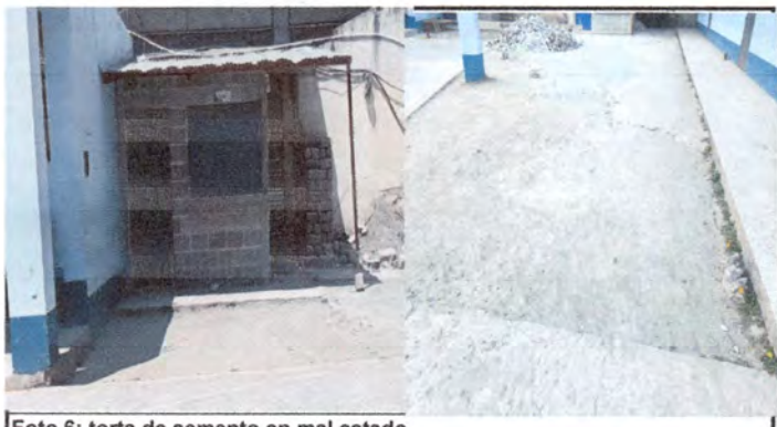
Foto 6: torta de semento en mal estado
