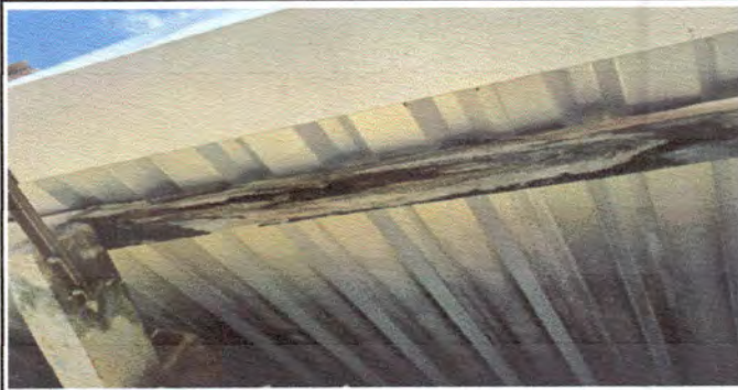
Foto1: Parte frontal de aulas, Techo Portante de madera en malas condiciones
