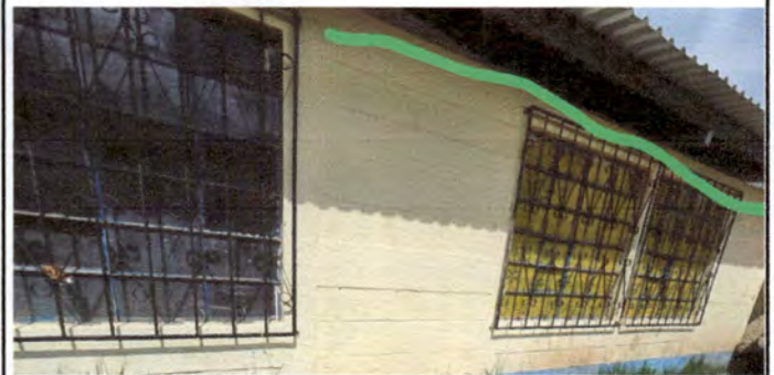
Foto20: Aula donde necesitamos colocar Block
