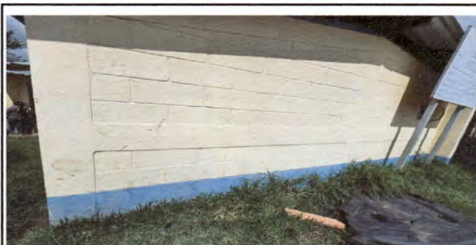
Foto 16: Aula de sexto parte exterior, espacio de pared para proteger por filtración
