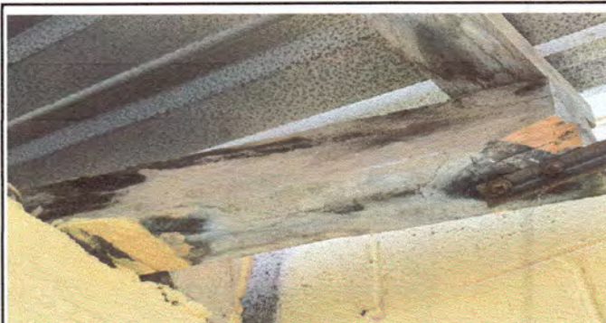
Foto 3: Techo portante de madera en malas condiciones
