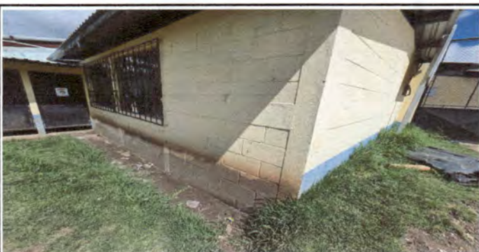
Foto 15: Aula de sexto parte exterior, espacio de pared para proteger por filtración
