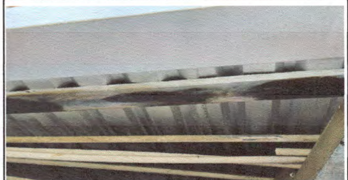
Foto 2: Parte Frontal de aulas, Estructura Portante de Madera en malas condiciones
