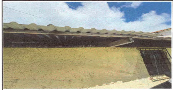
Foto 4: Techo Portante de Madera en malas Condiciones
