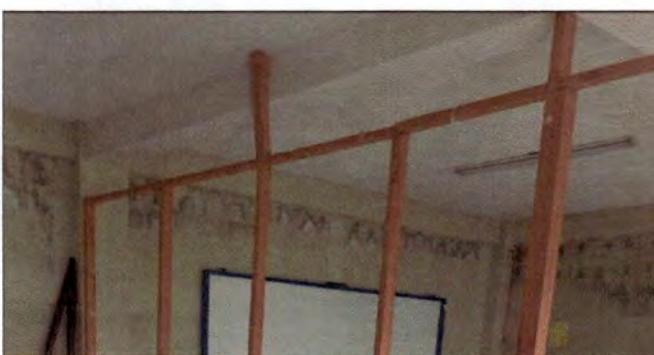
Foto 5: PANTAR PAREDES Y UTILIZAR IMPERMEABILIZANTE PARA LA HUMEDAD.
