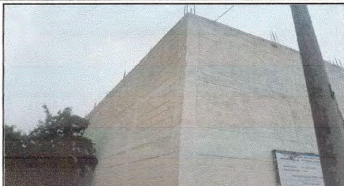
Foto 1: Repello exterior de pared con monocapa y eternocreto. (por filtración de agua cuando llueve)
