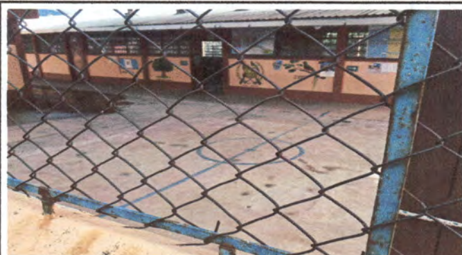
Foto 3: REJA CON CORROSIÓN
