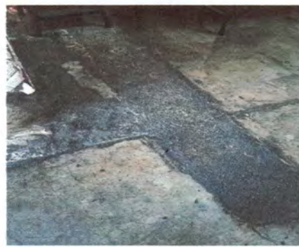
Foto 16: PISO DE CEMENTO TORTA DE CEMENTO POR PISO DUELA
