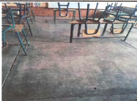
Foto 10: PISO DE CEMENTO TORTA DE CEMENTO POR PISO DUELA
