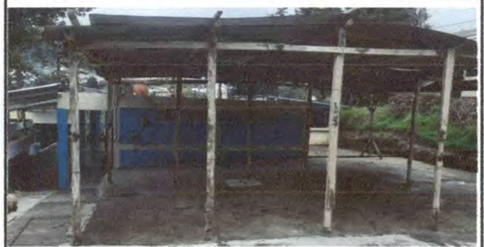
Foto 2: Costaneras de madera a sustituir con estructura de metal galvanizado.
