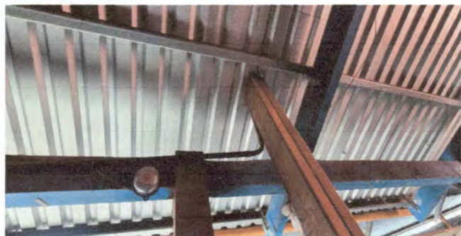
Foto1: Sellado de techo de lámina por filtración de agua pluvial en cocina
