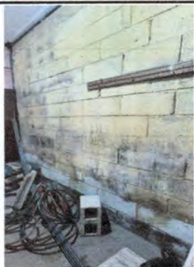
Foto1: Eliminación de humedad en paredes en bodega
