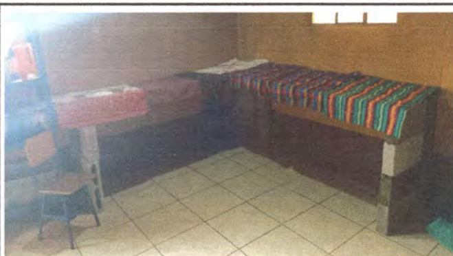
Foto 3: Priorización de gabinete de concreto y azulejo.
