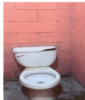
Foto 22: Sustituir sanitarios ya descompuestos
