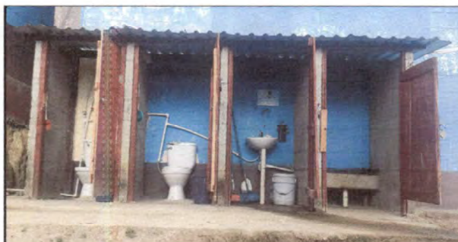
Foto 6: Inodoros, lavamanos, mingitorio y piso a sustituir
