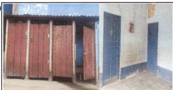
Foto 5: Puertas a sustituir
