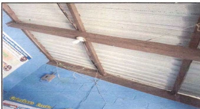
Foto 3: Vista del cableado eléctrico a reinstalar
