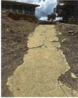
Foto 1: Área de deterioro de concreto que se sugiere remozamiento de losa de patio
