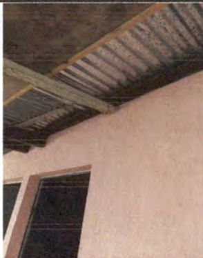
Foto 3: Área de deterioro de estructura de techo que se sugiere remozamiento de estructura de techo.
