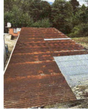
Foto 2: Área de deterioro de laminas que se sugiere remozamiento de cubierta de lamina.
