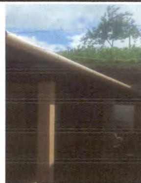
Foto 4: Área de deterioro de canales y bajadas pluviales donde se sugiere remozamiento.
