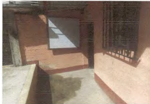
Foto 8: pintura del establecimiento en deterioro el cual se sugiere pintura de muros interiores y exteriores en todo el establecimiento.
