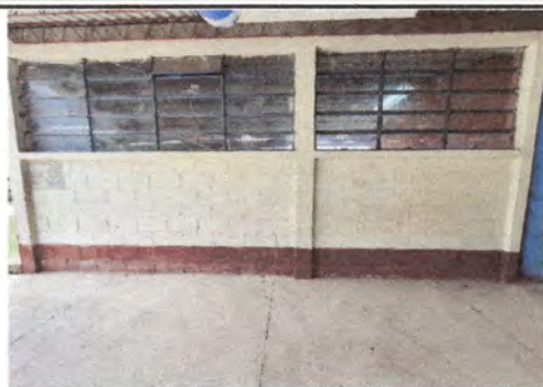
Foto 1: Ventanas ubicadas en el pasillo de la escuela que necesitan balcones para mayor seguridad.
