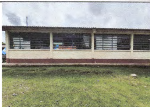
Foto 2: Ventanas ubicadas en la parte exterior de la escuela que necesitan balcones para mayor seguridad.
