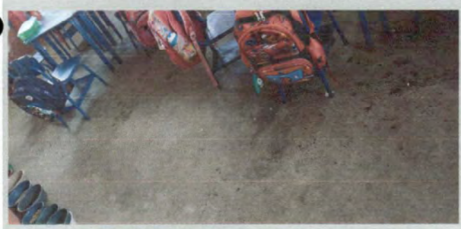
Foto 5: Vista del aula 1 que requiere instalación de piso
