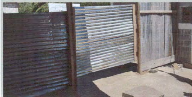
Foto 2: Vista de la cerca perimetral de la entrada al establecimiento que requiere sustitución
