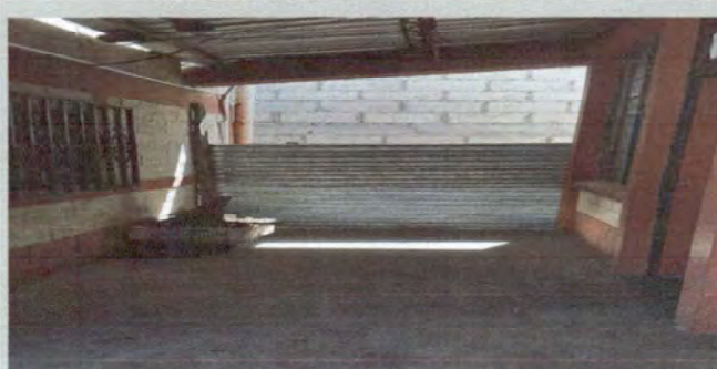
Foto 4: Vista del portón lateral del establecimiento que requiere sustitución
