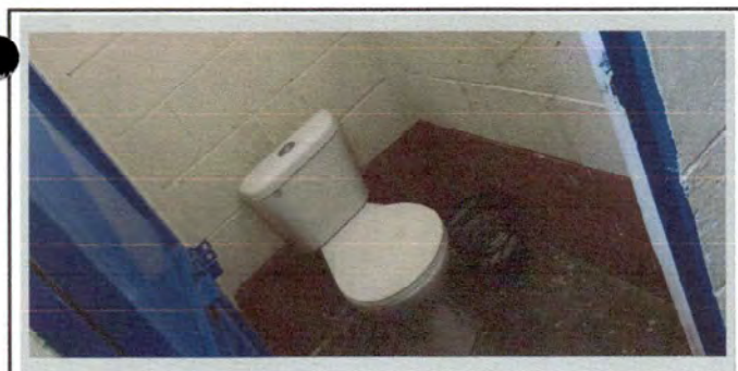
Foto 9: Vista de los baños que requieren sustitución de sanitarios
