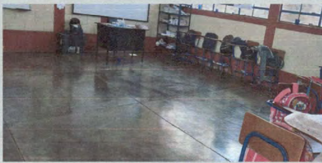
Foto 6: Vista del aula 2 que requiere instalación de piso
