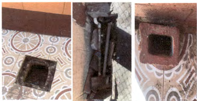
FOTO 13. LLAVES DE PASO DE AGUA EN MAL ESTADO
