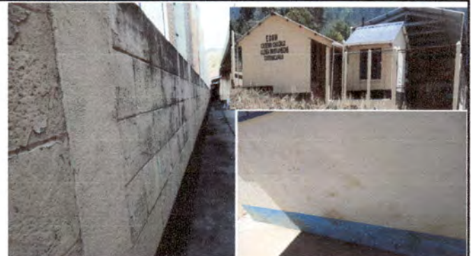
FOTO 10. PAREDES DE CIRCULACIÓN, Y AULAS QUE NECESITAN PINTURA
