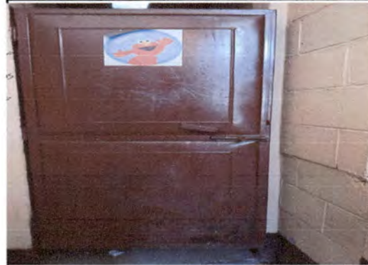
FOTO 8. MANTENIMIENTO DE PUERTAS SUCIAS DE LOS BAÑOS
