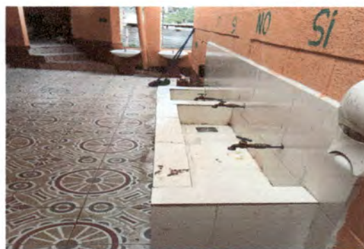
FOTO 16. RED DE TUBERIAS EN EL LAVAMANO QUE NECESITA REPARACIÓN GOTEA AGUA DESDE LA PARED Y CAMBIO DE AZULEJOS
