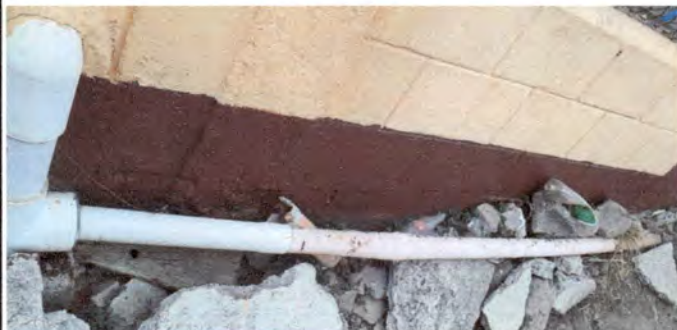
FOTO 14. TUBERIAS QUEBRADOS Y EN MAL ESTADO DE LA RED DE DRENAJE
