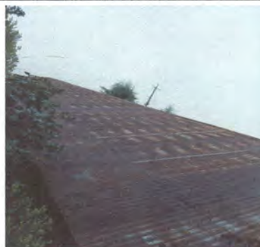
Foto 2: Contempla el deterioro y óxido de las láminas del techo de la escuela
