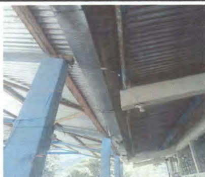
Foto 5: Muestra el deterioro de los cables del sistema eléctrico desde otro ángulo.
