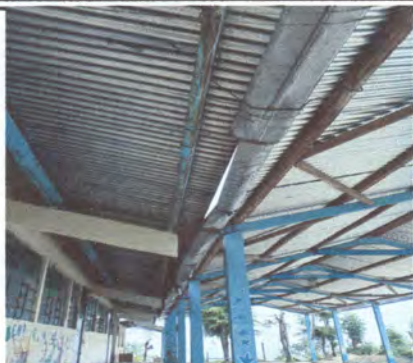
Foto 1: Contempla el deterioro del canal de caída de agua pluvial.
