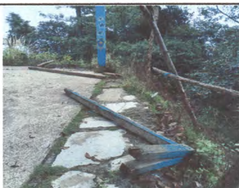
Foto 3: Se observa la malla tirada inservible.
