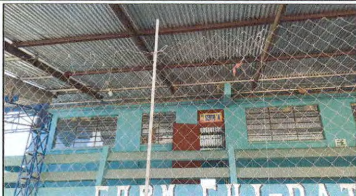
Foto 7: Sustrucción de malla de muro perimetral, en una parte de la circulación perimetral del edificio escolar.
