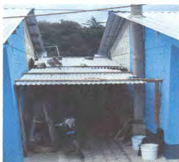
Techo de lamina en mal estado
