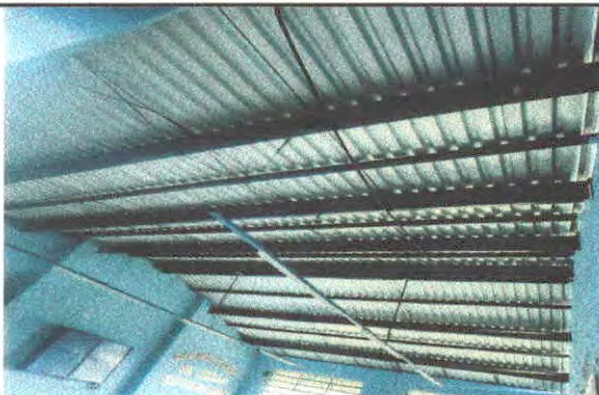
Foto 5: Estructura de metal con falta de mantenimiento
