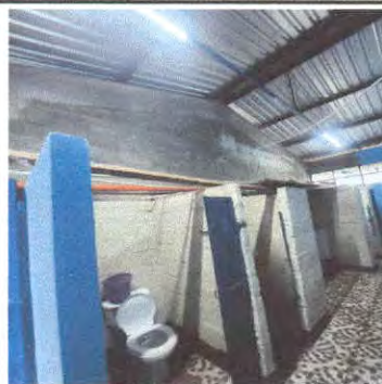
Foto 6: baños con falta de pintura
