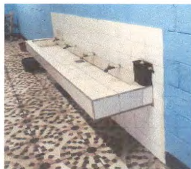
Foto 4: Chorros de lavamanos en mal estado
