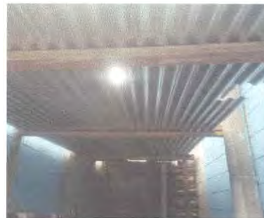
Estructura de madera en mal estado
