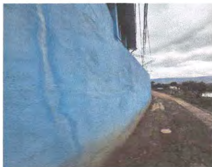
Foto 5: Muro perimetral con falta de pintura
