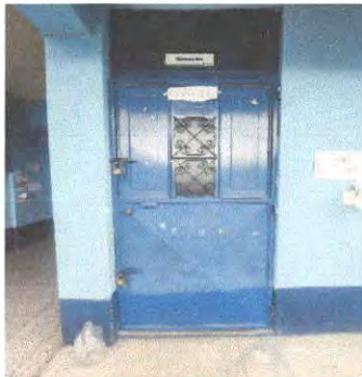
Foto 3: Puertas de metal falta de mantenimiento y pintura
