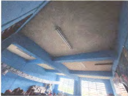
Foto 1: Lamparas de ganeon en mal estado
