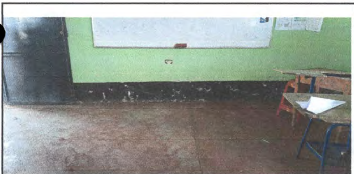
Foto 5: El piso de las aulas ya estan desgastado,
