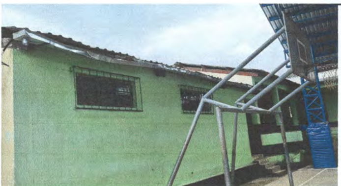
Foto 3: la dobladura, del canal por golpes no completa con las funciones de recaudar el agua.
