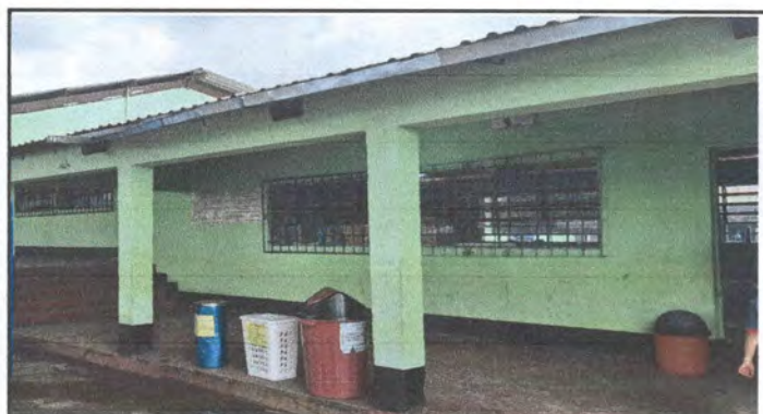
Foto 4: el canal presenta, dobladura por alto caudal del agua, presenta goteras.
