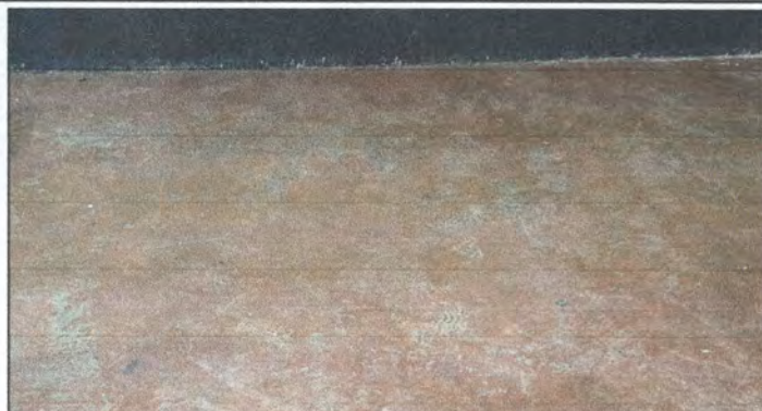
Foto 2: De igual manera se ve el desgaste de piso, por que se trapea diariamente se ha desgastado.
