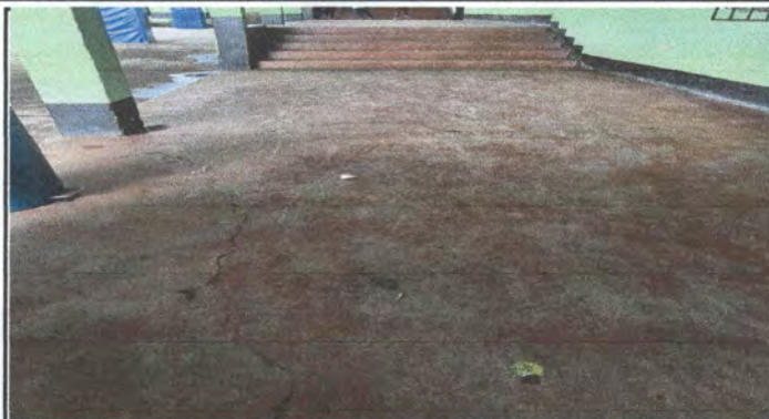
Foto 1: daño en el piso en relación al color y presenta algunas fisuras por el tiempo que lleva de construcción el establecimiento.
