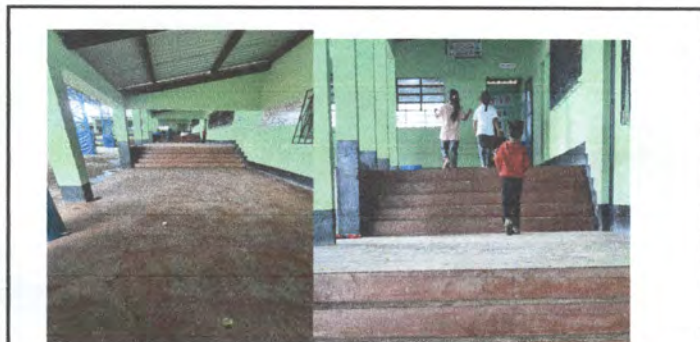
Foto 6: El corredor el piso tambien ya está desgastado
