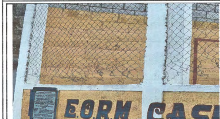
MALLA EN EN MAL ESTADO SE SUTITUIRA POR BARANDAS
