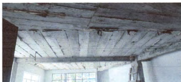
Foto 3: Repello cielo tipo antiguo, Segundo A
