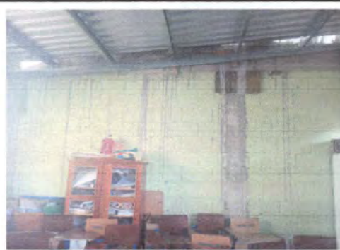
Foto 2: Repello tipo antiguo de paredes, Cuarto B
