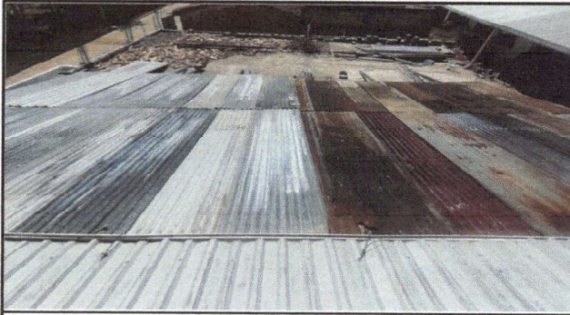
Foto 1: Parte de arriba lado norte del entechado
