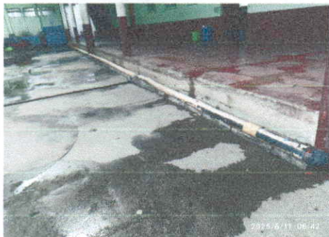
Foto 13: Mejoramiento de sistema de bajadas de agua que se encuentra en deterioro
