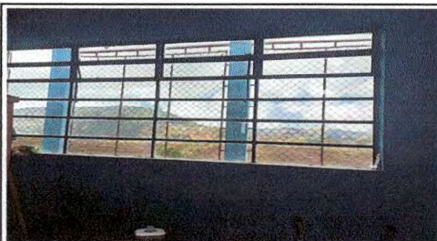
Foto 3: Sustrucción de ventana en la cocina.
