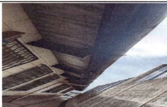
Foto 3: CANALETAS Y BAJADAS DE AGUA PLUVIAL EN MAL ESTADO
