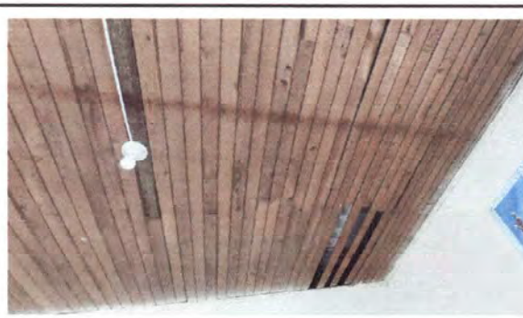
Foto 4: MACHIMBRES EN MAL ESTADO DEL AULA DE PARVULOS 2
