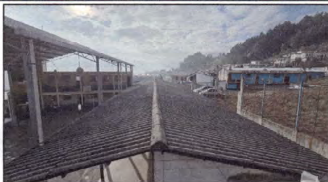
Foto 1: TECHO DE 3 AULAS, DIRECCION Y CORREDOR EN MAL ESTADO.
