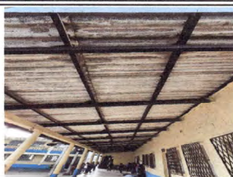
Foto 2: LAMINA EN MAL ESTADO EXTERIOR DEL CORREDOR
