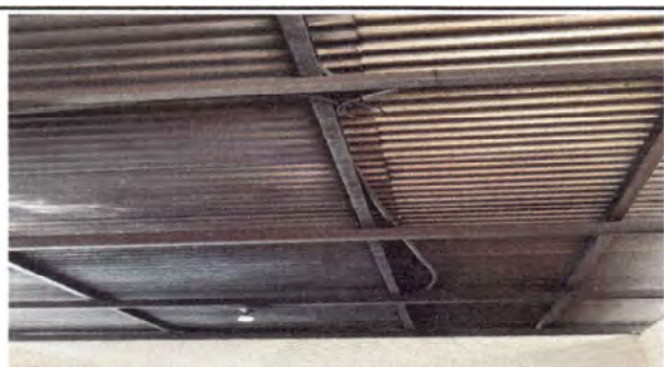
Foto 5: TECHO INTERIOR DE COCINA EN MAL ESTADO
