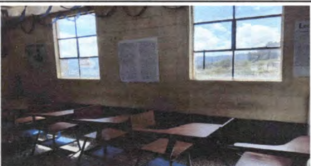
Foto 9: PINTURA DE PARED INTERNA DE AULA EN MAL ESTADO
