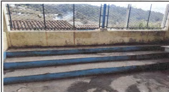
Foto 8: PINTURA DE CIRCULACION CON MALLA INTERNA EN MAL ESTADO
