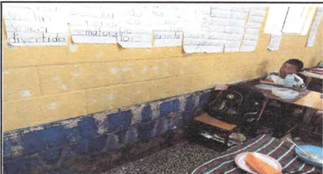
Foto 4: PINTURA DE PARED INTERNA DE 11 AULAS EN MAL ESTADO
