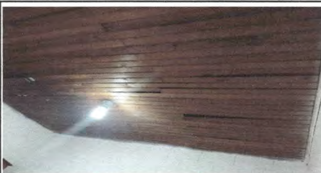
Foto 5: MACHIMBRE DE DIRECCION Y SALA DE REUNIONES EN MAL ESTADO
