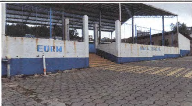
Foto 7: PINTURA EN MAL ESTADO DE CIRCULACION EXTERNA CON MALLA.
