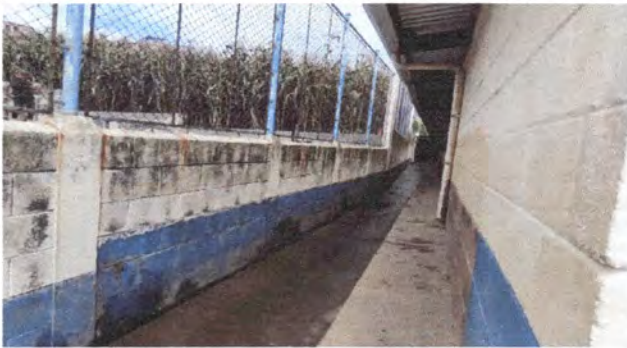
Foto1: PINTURA EN MAL ESTADO DE CIRCULACION CON MALLA.
