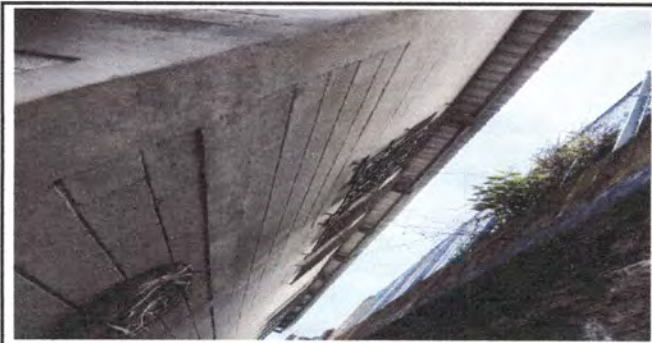
Foto 6: FALTA DE DE CANAL Y BAJADAS DE AGUA PLUVIALES
