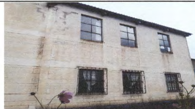
Foto 3: PINTURA DE PARED EXTERNA EN MAL ESTADO
