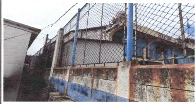
Foto 2: PINTURA DE CIRCULACION CON MALLA EN MAL ESTADO
