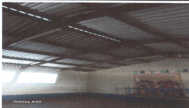
Foto 7: Comedor, en esta área se cambiará el cableado eléctrico y pintura.
