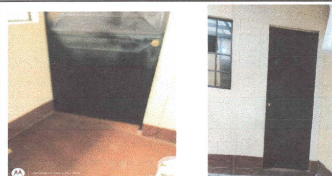
Foto 12: LAS PUERTAS DE COCINA Y BODEGA: SE VAN HA REPARAR.
