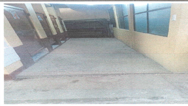
Foto 10: FRENTE A LOS SANITARIOS, COLOCAR PISO ANTIDSLIZANTE..
