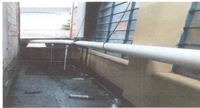
Foto 8: GRADAS DE METAL EN LA PARTE DE ATRÁS DE LA ESCUELA, SE VAN HA CAMBIAR POR GRADAS
