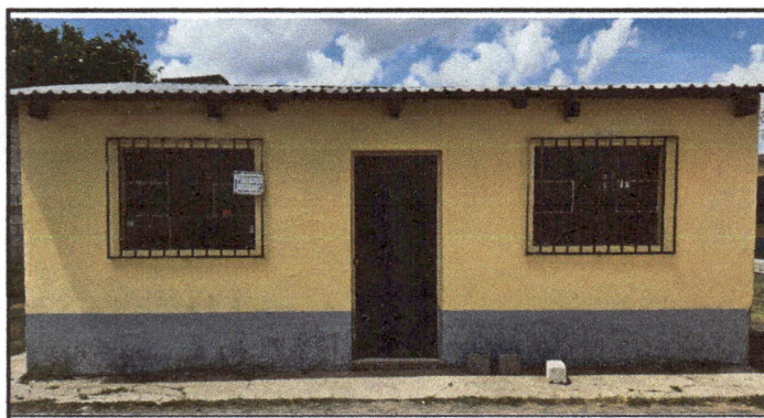
Foto 5: Cocina (puerta, ventana y balcon)
