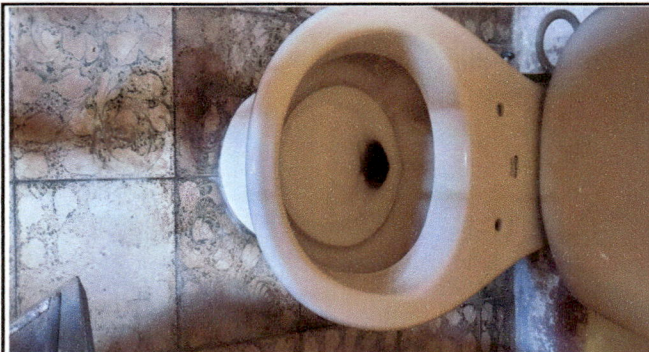
EN ESTA FOTO SE MUESTRA EL CAMBIO NECESARIO DEL SANITARIO
