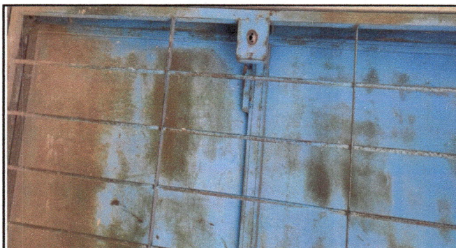
EN ESTA FOTO SE MUESTRA EL CAMBIO NECESARIO DE LA PUERTA PRINCIPAL
