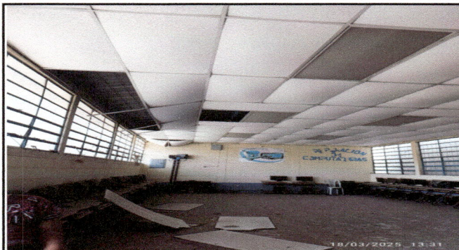
EN ESTA FOTO SE MUESTRA EL CAMBIO NECESARIO DEL TECHO
