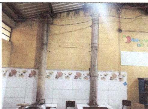
Foto 4: Chimeneas de cocina
