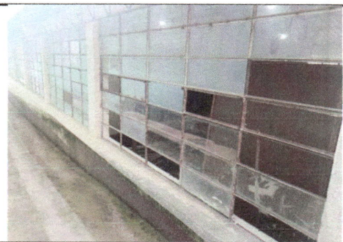
Foto 5: Vidrios rotos y falta de balcón
