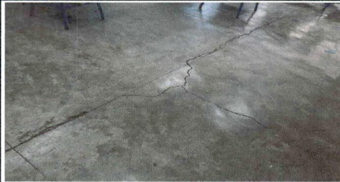
Foto 2: Fotografía de aula de piso de torta de cemento en el aula de tercero B
