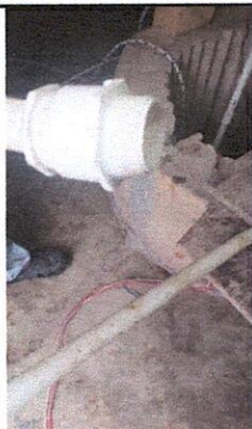
FOTO 7: Sustrucción de bomba de agua.
