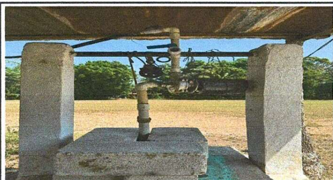
Foto 4: Sustrucción de bomba de agua
